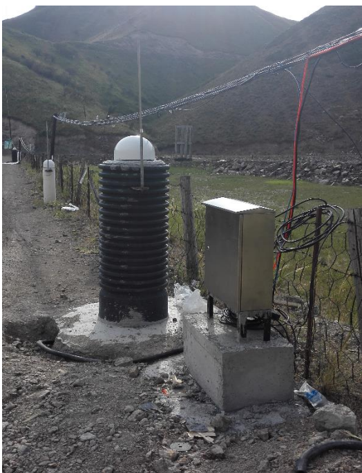
尾矿库坝体变形监测设备（2019.07）
